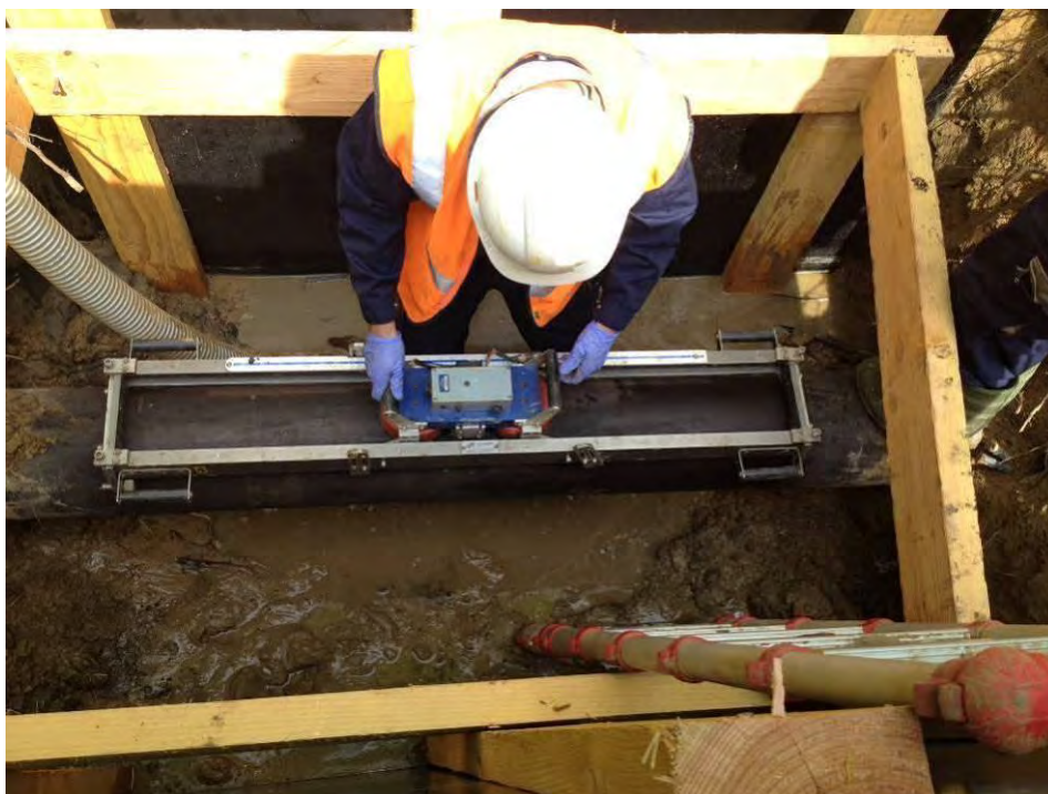
Figure 56 : Scan de la canalisation
