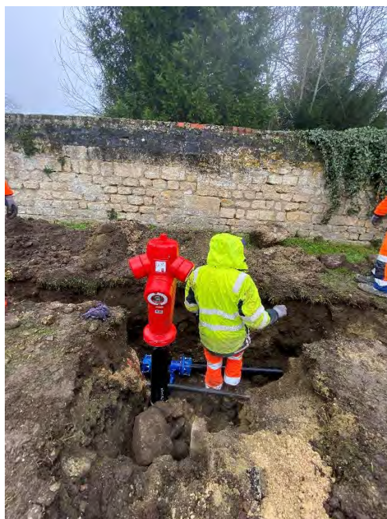
Figure 68 : Poteau d'incendie MON 10 renouvelé – Rue de la République à Monchy Saint Eloi (Régie CCLVD)
