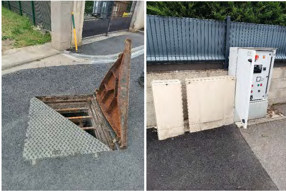
Figure 143 : Nouveau poste de relevage rétrocedé – PR IMMO France à Mogneville
