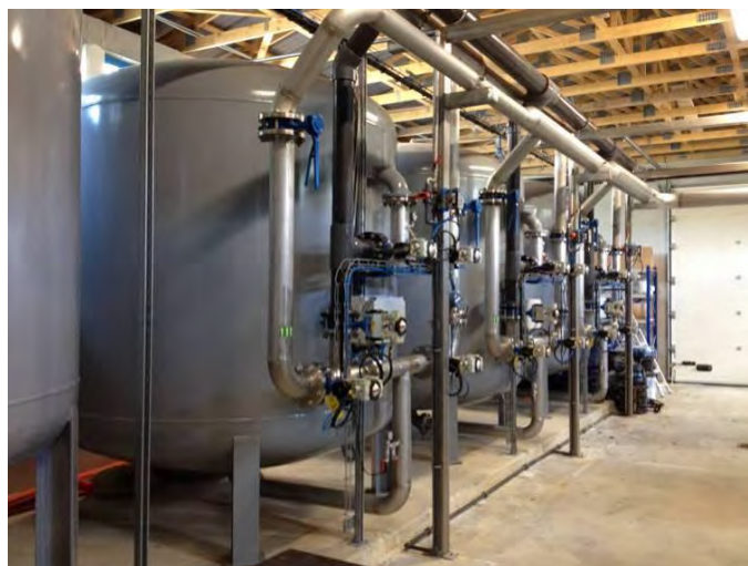
Figure 35 : Usine de déferrisation
