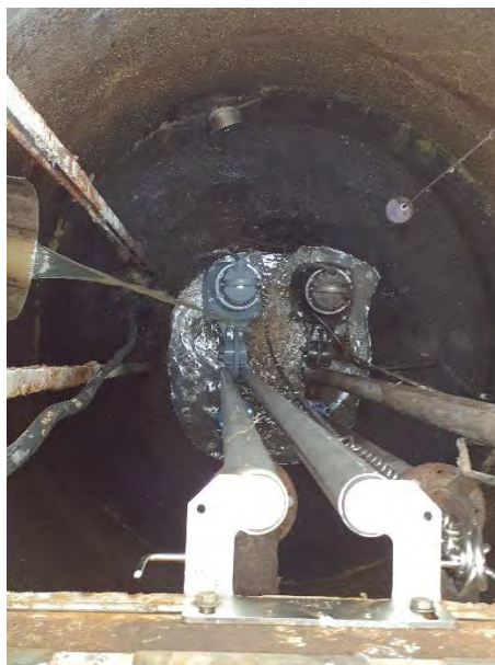
Figure 148 : Renouvellement d'une pompe sur le PR « MARAIS » à Rosoy (VEOLIA)
