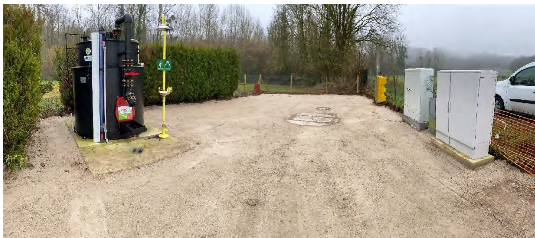
Figure 159 : Traitement anti H_2S du PR PONCEAU à Verderonne
