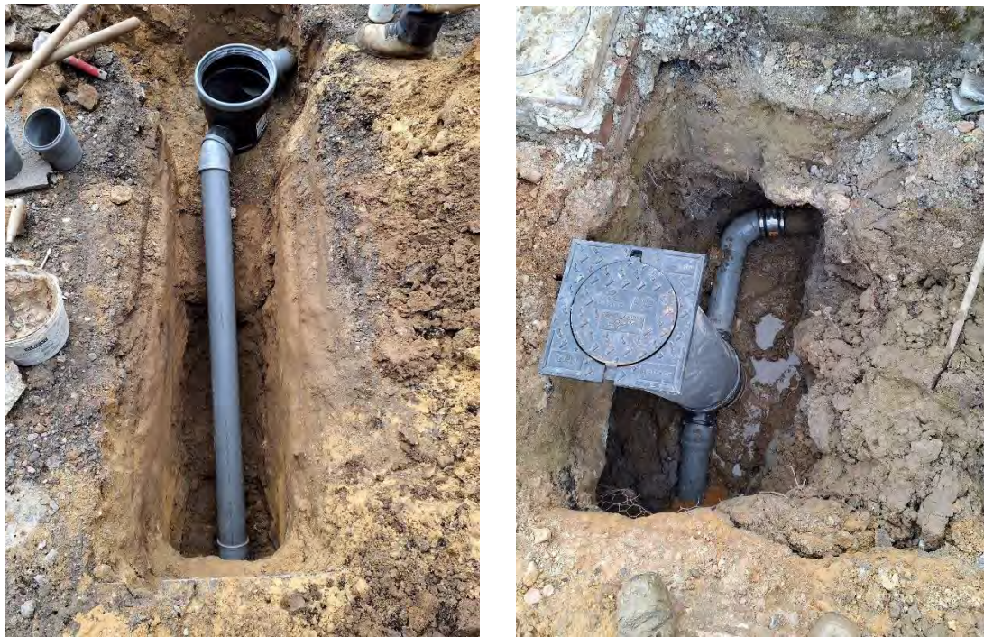
Figure 139 : Exemple de branchement réalisé par DMVA
