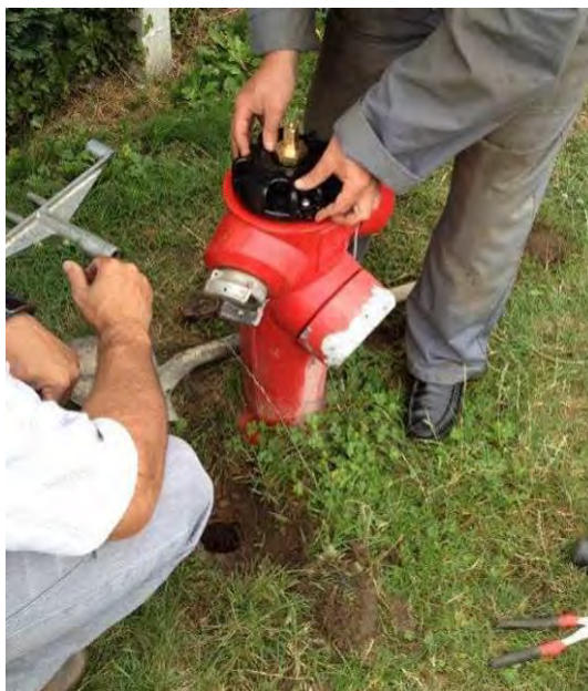
Figure 72 : Pose du Copernic sur le poteau d'incendie à l'angle de la rue du Saint-Sacrement et de la rue Paul Faure à Mogneville
