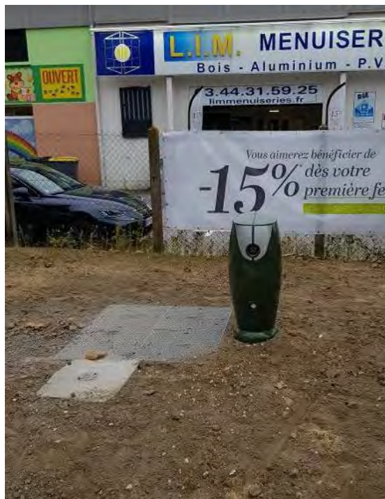
Figure 74 : Borne de puisage – Avenue Henri Besse à Cauffry
