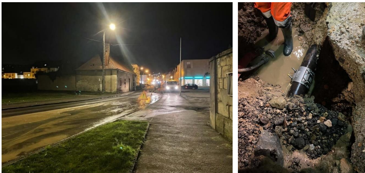
Figure 69 : Fuite sur conduite Rue Victor Hugo à Liancourt (février 2022)
