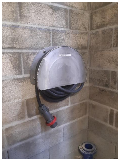
Figure 45 : Câble en attente pour raccorder un groupe électrogène – Poste de surpression à Labruyère (VEOLIA)
