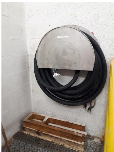
Figure 23 : Support et câble en attente de raccordement d'un groupe électrogène (VEOLIA)
