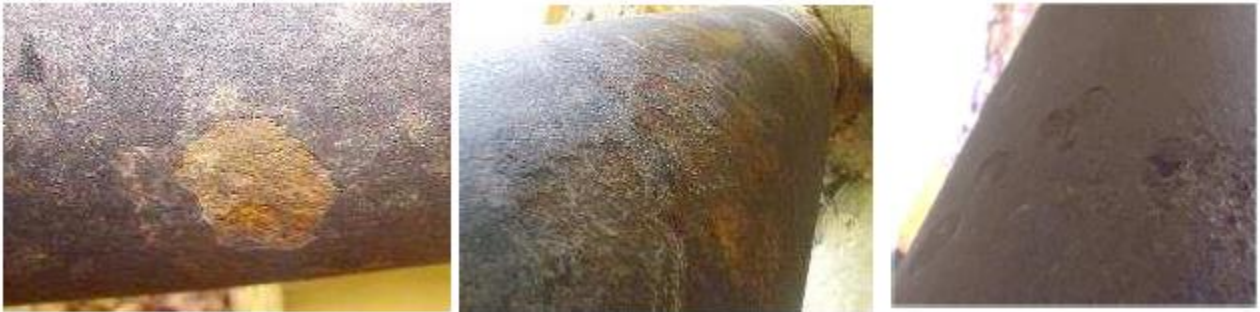
Figure 64 : Canalisation du chemin Berenger à Labruyère
