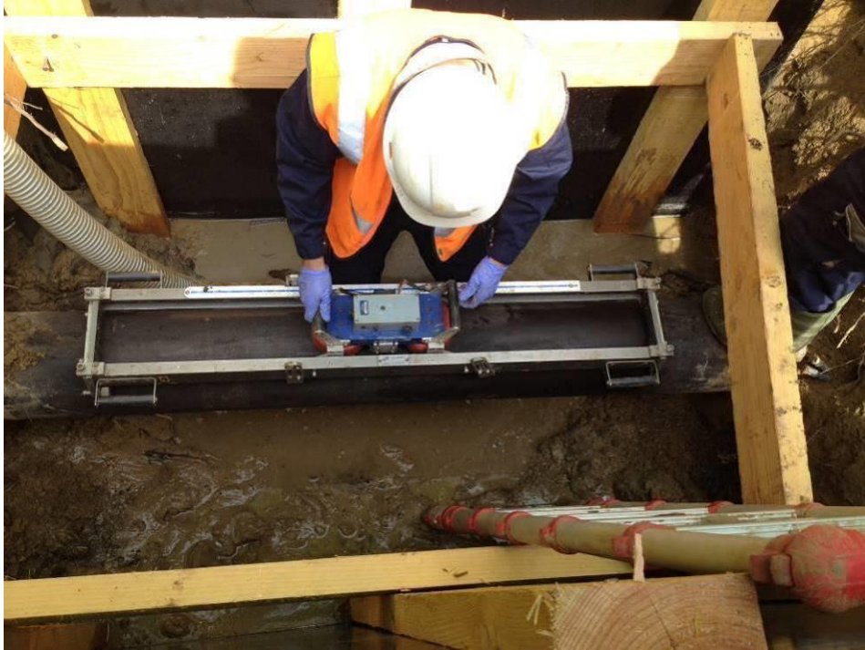
Figure 63 : Scan de la canalisation
