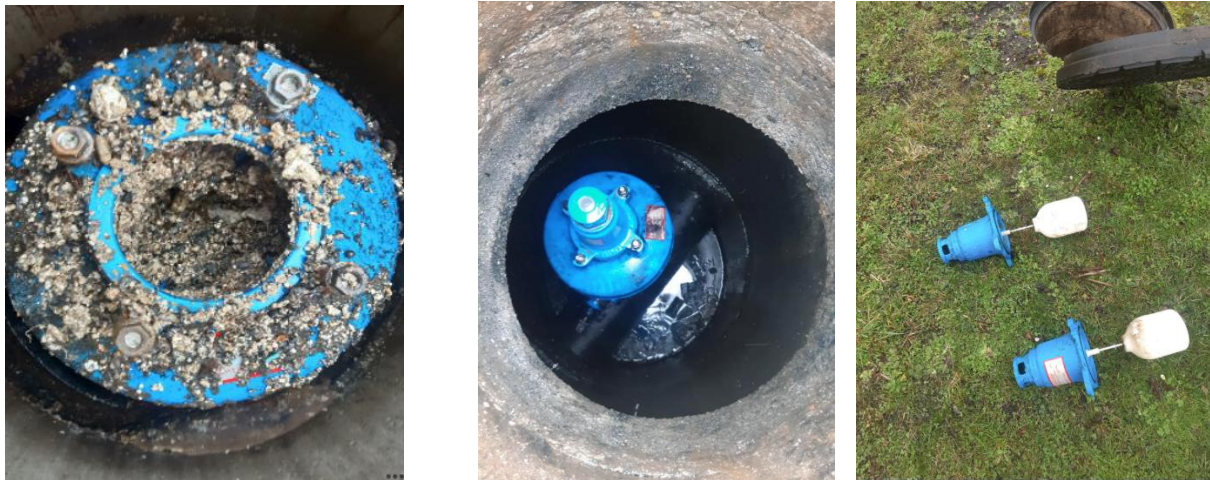
Figure 148 : Ventouses sur les refoulements du PR « BEREGOVY » à Liancourt (VEOLIA)
