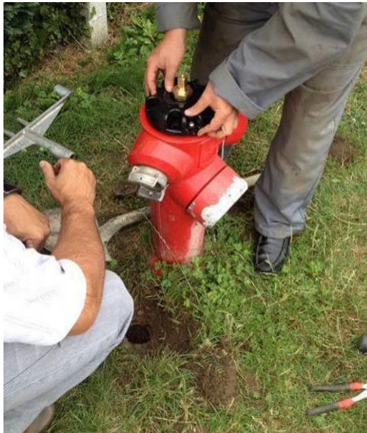
Figure 74 : Mogneville- Pose du Copernic sur le poteau d'incendie à l'angle de la rue du Saint-Sacrement et de la rue Paul Faure
