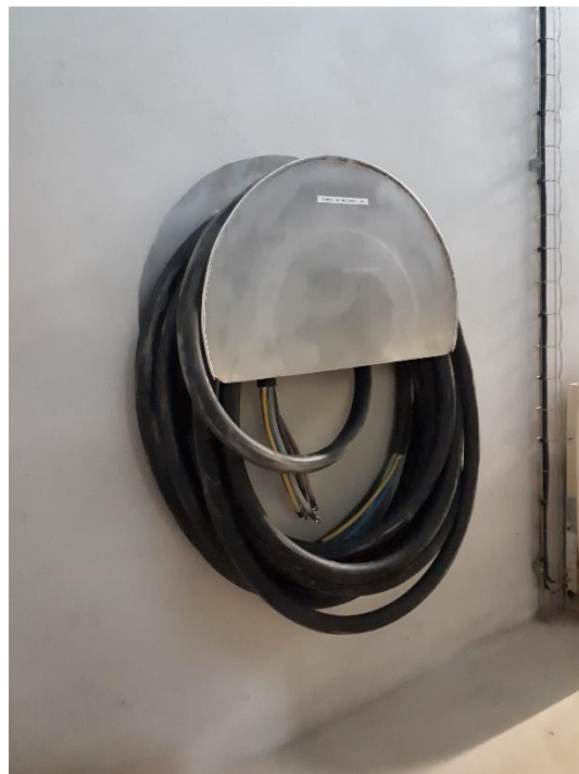
Figure 35 : Support et câble en attente pour raccorder un groupe électrogène (VEOLIA)
