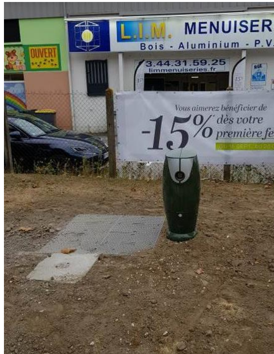
Figure 76 : Borne de puisage – Avenue Henri Besse à Cauffry
