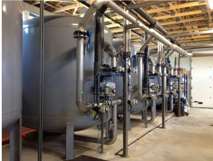
Figure 34 : Usine de déferrisation
