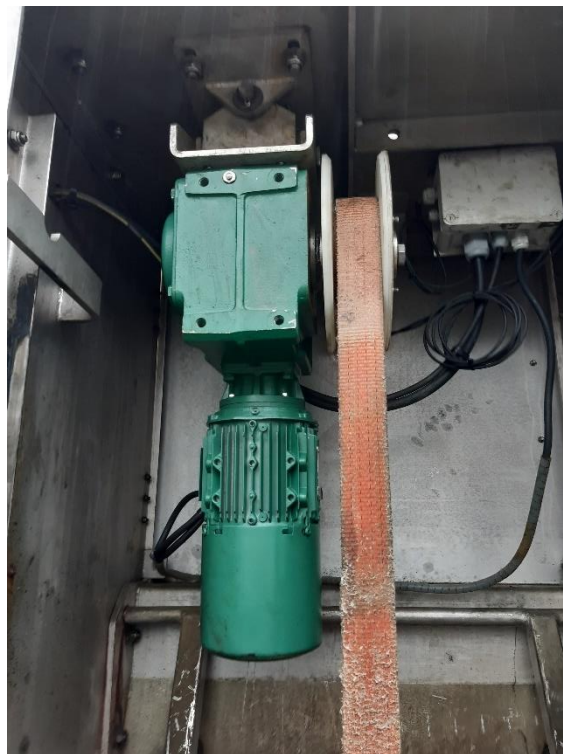
Figure 164 : Motoréducteur dégrilleur (VEOLIA)
