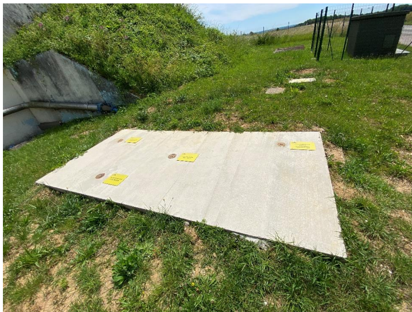
Figure 41 : Dalle béton et étiquettes – Réservoirs semi-enterrés (REGIE CCLVD)
