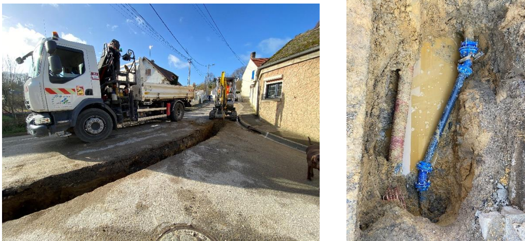
Figure 50 : Renouvellement du réseau – Rue du bout du monde à Cauffry (Régie CCLVD)
