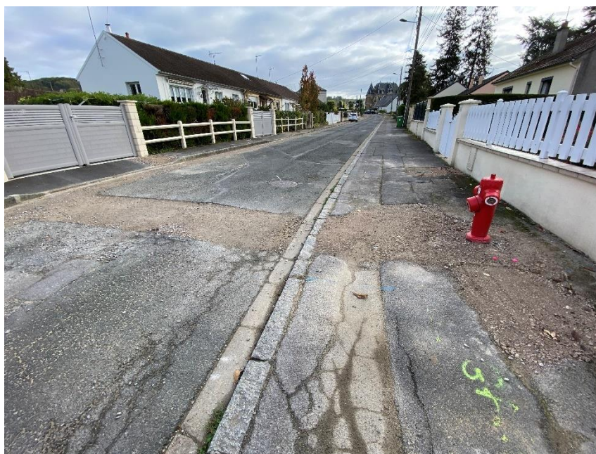
Figure 73 : Renouvellement du poteau d'incendie LIA 50 – Rue des quinconces à Liancourt (Régie CCLVD)
