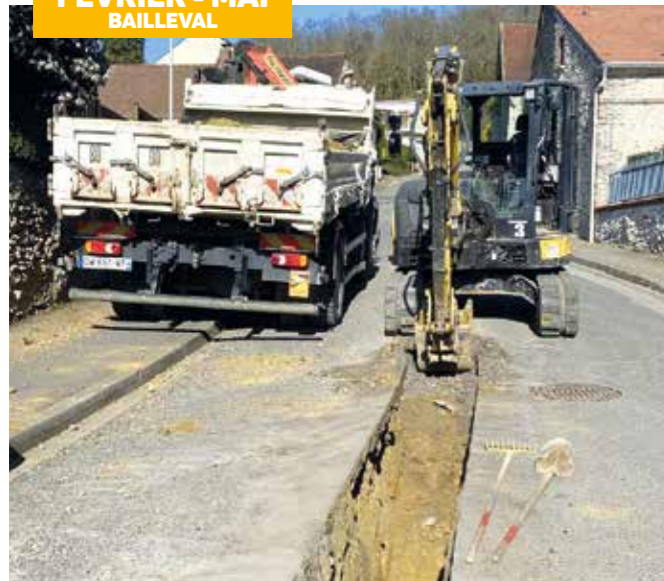
Rue aux Dames et Rue Hôtel Guehain - Renouvellement des canalisations et des branchements d'eau potable.
